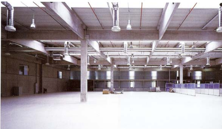
Großes Augenmerk galt der Kühlung: Neben Teilklimaanlagen und dezentraler Befeuchtung sorgen acht dezentrale Umluftkühlgeräte für das Abführen der hohen, internen Wärmelasten
